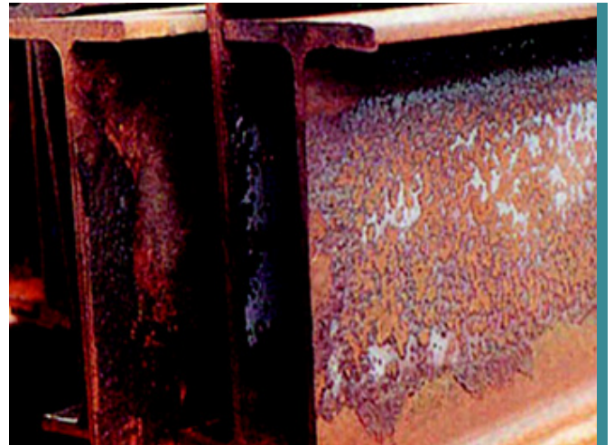
ウェブ上のミルスケールが剥離したH鋼 Clause : 錆の付着、表面の錆の斑点
