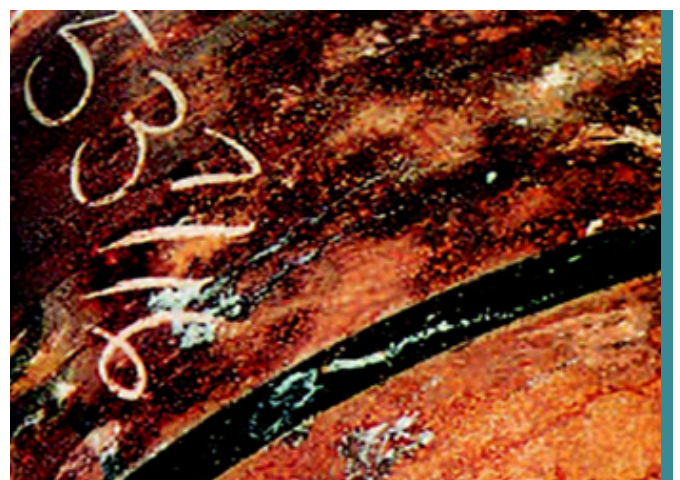
錆の状態および色から塩化物と接触したと思われる熱間圧延コイル Clause : 「錆」に関するいずれかのClause + 硝酸銀液試験に反応を示す表面部分
