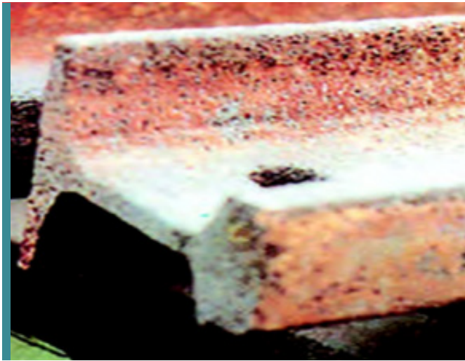
レール Clause : 孔食された錆
